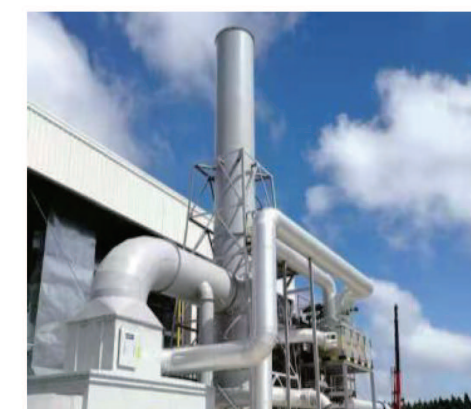
▲上海电站辅机厂沸石转轮+RTO系统
