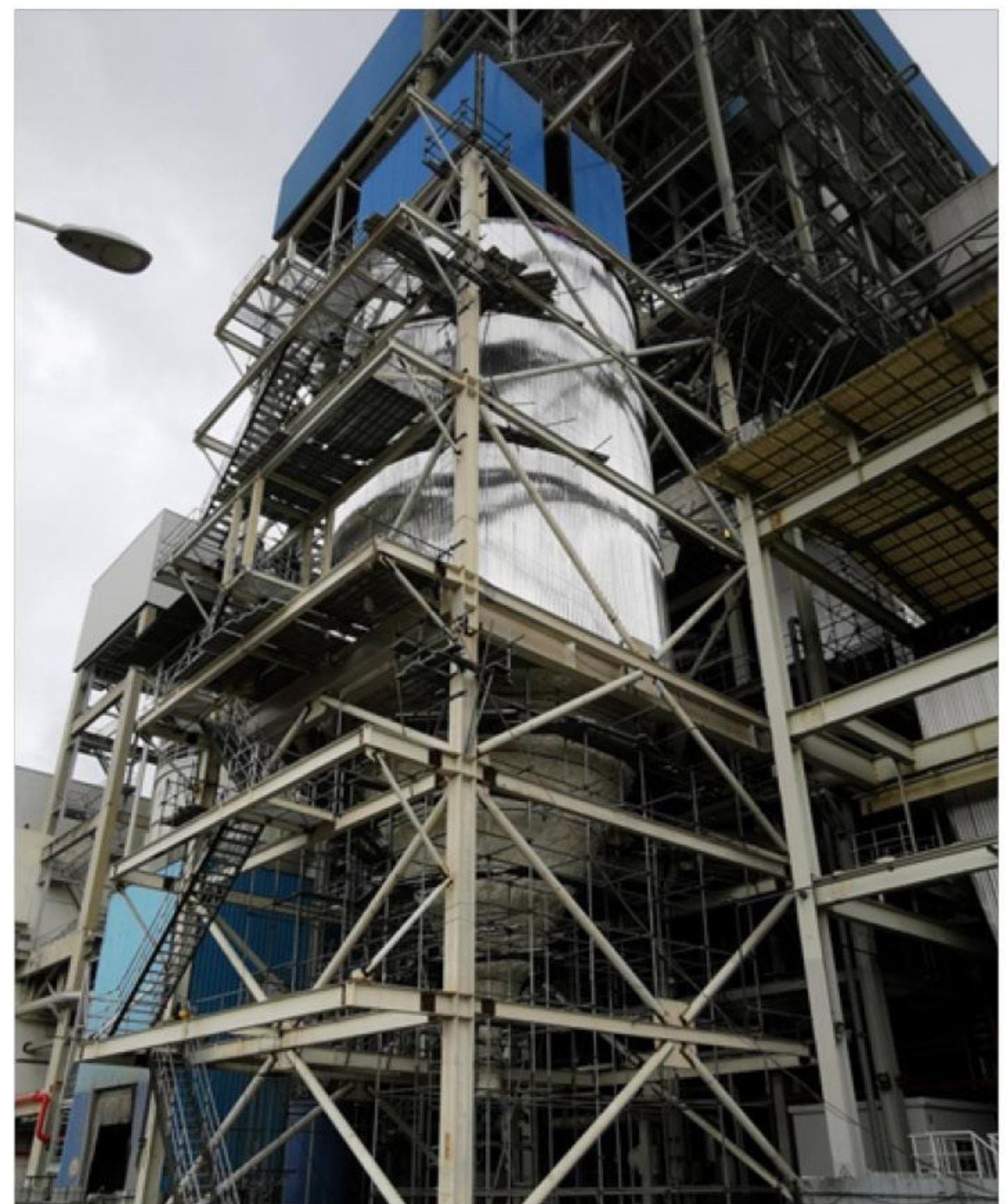
广东平海 20t/h 脱硫废水零排放改造项目
