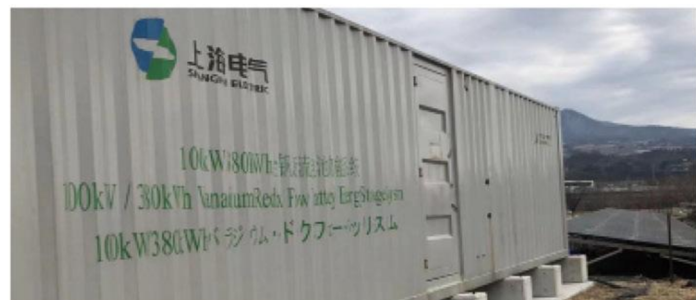
日本山梨县光储微网 100KW/380KWh 研究示范项目
