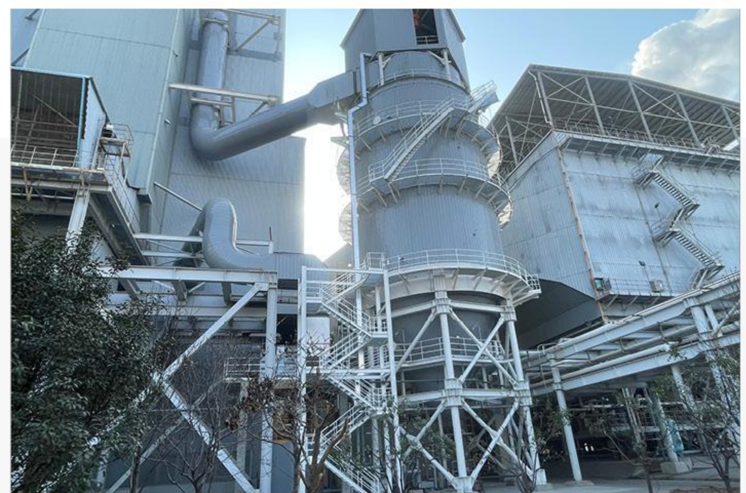
安徽淮北平山 脱硫废水零排放 EPC 项目
