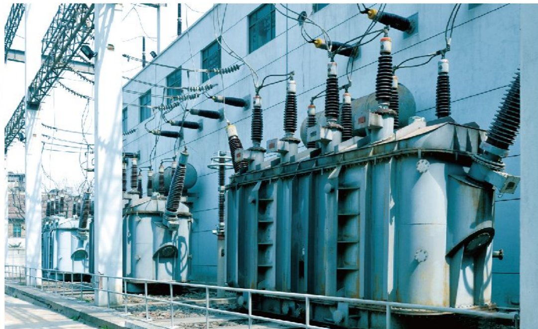
220kV/60MVA (1500MVA) 冲击试验变压器组 220kV/60MVA (1500MVA) Impact Testing Transformer Bank
